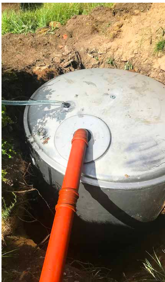
Inloppsroret i manluckans hål med gummimuff emellan. Tankens hål för mjölkkomröraren används för att dra ut pumpens slang och kabel. Tätas med stark elastisk tejp.
