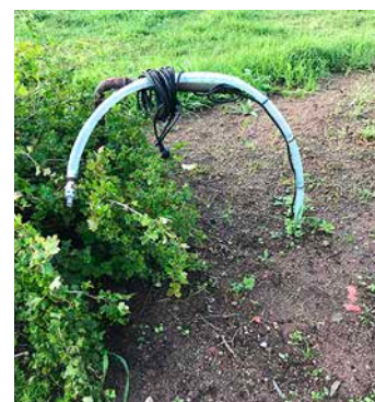
Tanken är helt nedgrävd. Bara dränkpumpens slang och elkabel sticker upp.
