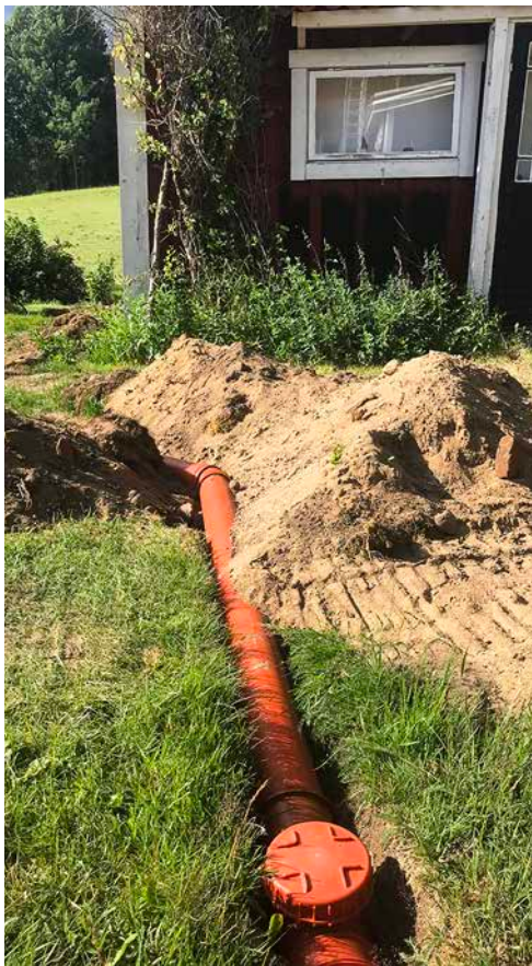
Grov ledning, 110 mm, och bra fall, minst 4 %, förebygger urinsten. Vår ledning ligger just under markytan eftersom vi bor på hälleberget. I förgrunden den enkla rensbrunnen där vi kan gå in med högtryckstvättens specialmunstycke.
